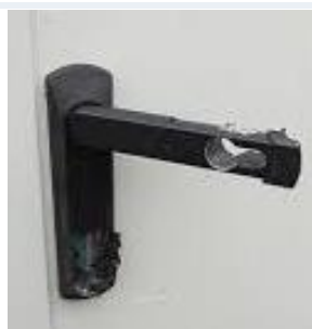
Serrure PM vandalisée
