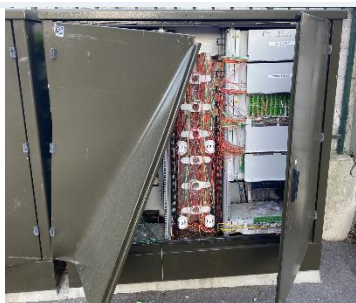
Porte PM arrachée
