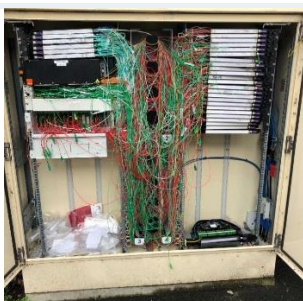
PM avec jarretières mal passées et déchets abandonnés
