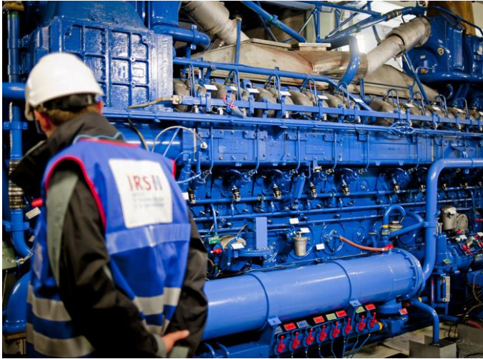
Groupe électrogène à moteur diesel du réacteur n°1 de la centrale du Blayais, en Gironde (© Stéphanie Jayet/IRSN)
