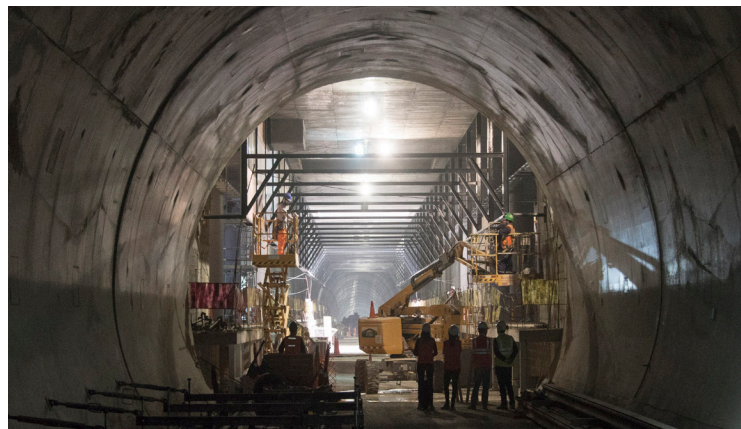
Un tunnel et une station de métro offrant un système de transport plus sûr et plus durable sont en construction à Lima (Pérou).
