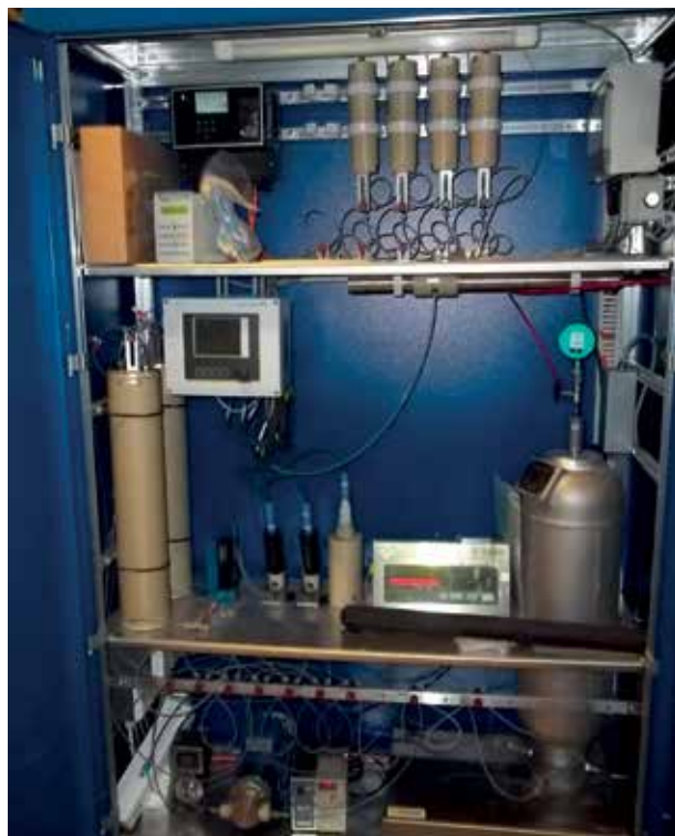
Expérience DRO : photographie d'un module de circulation d'eau raccordé au forage PAC1001 dans la galerie GEX du Laboratoire souterrain et permettant de faire circuler la solution contenant l'ISA au contact de la roche
