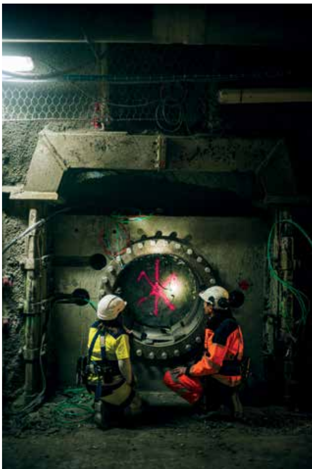
Photographie d'un démonstrateur d'alvéole HA dans le Laboratoire souterrain de Meuse/Haute-Marne
